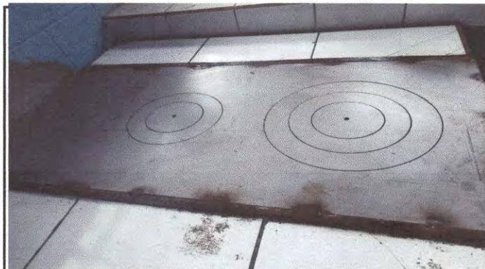
Foto 4: Estas son las planchas con las que cuenta ahora la cocina de la escuela.
