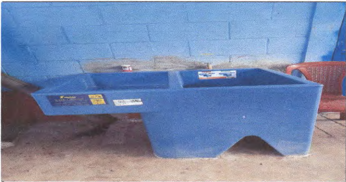
Foto 5: Pila instalada en la cocina del establecimiento.
